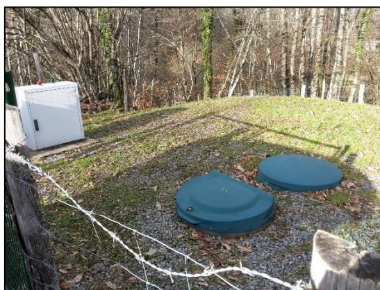
Photo 1 : Poste de refoulement route de la Brionne
