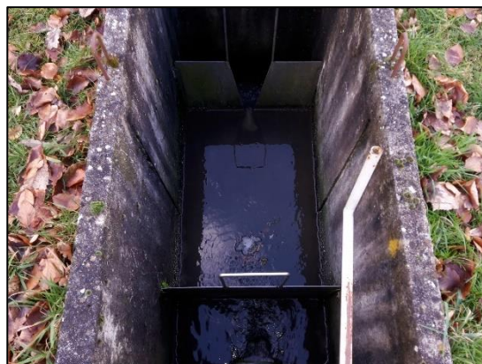
Photo 3 : Canal de comptage
